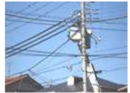
電源を入れて 作業終了
