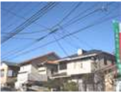
工事前: 電話線と電気の線が 接触している状態
